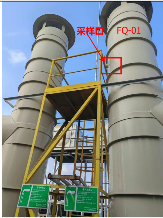
FQ-01 排气筒及采样平台
